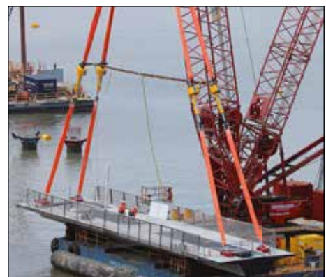
▼ SyncHoist levanta y posiciona vigas de hormigón en la rivera de Brisbane.
